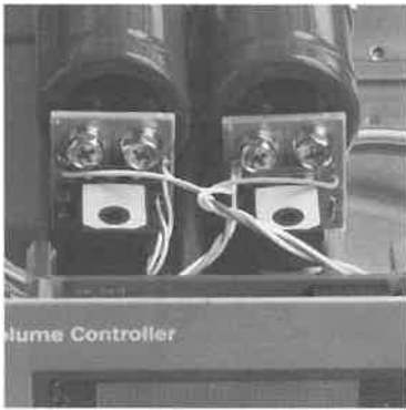
《写真F》ケミコンに取付けた整流部基板線が良好です。
