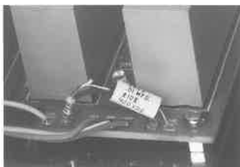
【写真 B】 出力端近くに取付けたゾベル・フィルタ
